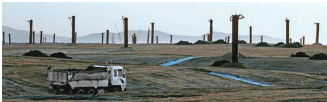
Recouvrement du sol d'un site des décharges de Geomdan. Les tuyaux sont destinés à la capture du méthane pour la production d'électricité.
